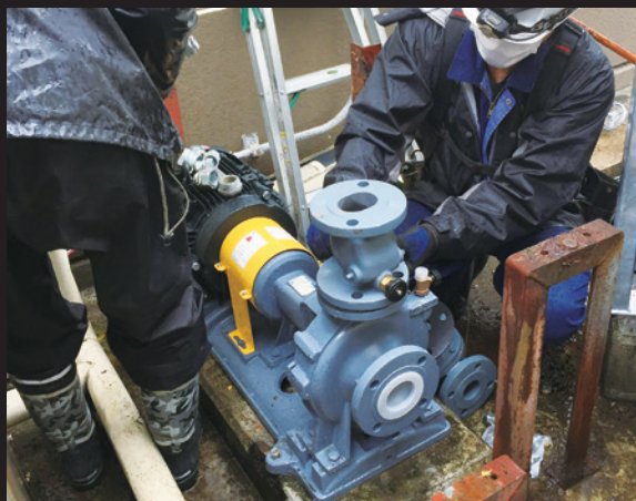
金属加工工場向け陸上ポンプの取替
